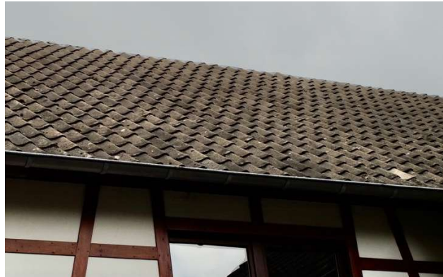
Seit 1948 auf dem Dach!
